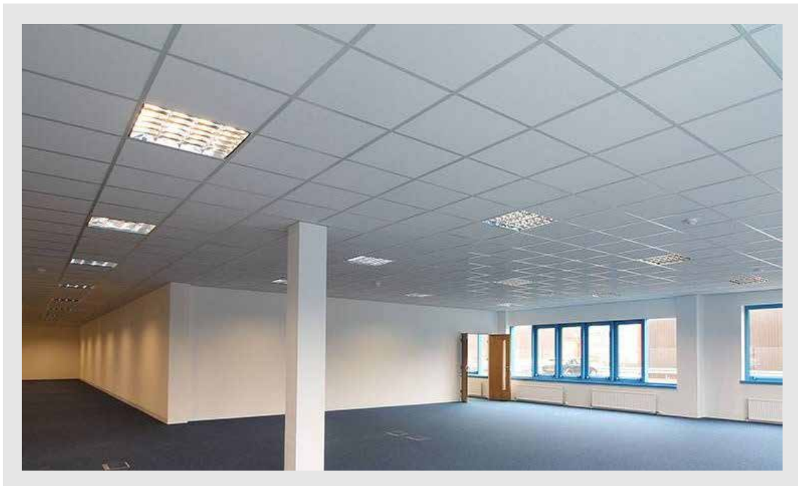
Hình ảnh minh họa thi công trần nổi bằng tấm thạch cao 8mm
